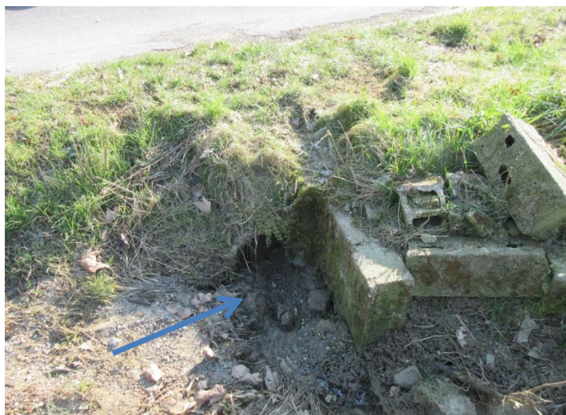
Fig. 9. BV n°1c - Exutoire du sous-bassin versant numéro 1c
