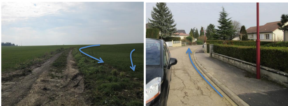
Fig. 4. BV n°1 - Sens d'écoulement de l'eau au droit de l'exutoire de la parcelle
