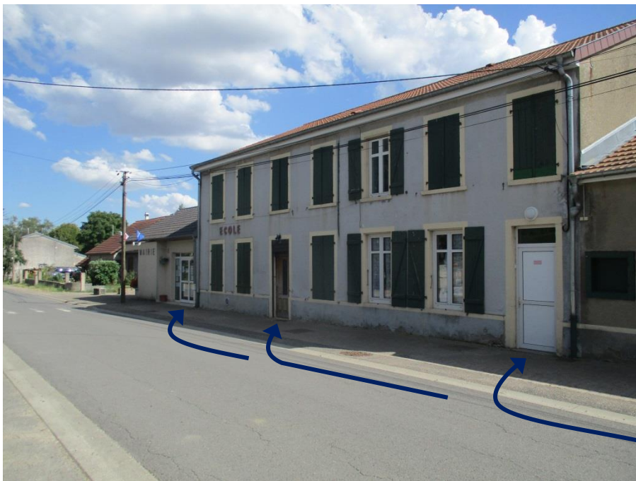
Fig. 6. Suite de bâtiments ayant été inondée en 2016
