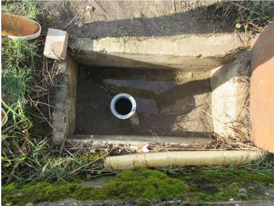
Fig. 6. Buse permettant l'évacuation de l'eau au pied du deuxième bassin versant
