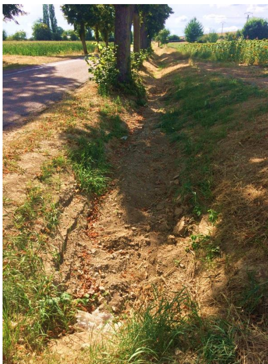
Fig. 6. BV n°2 – Photo de l'encombrement du fossé
