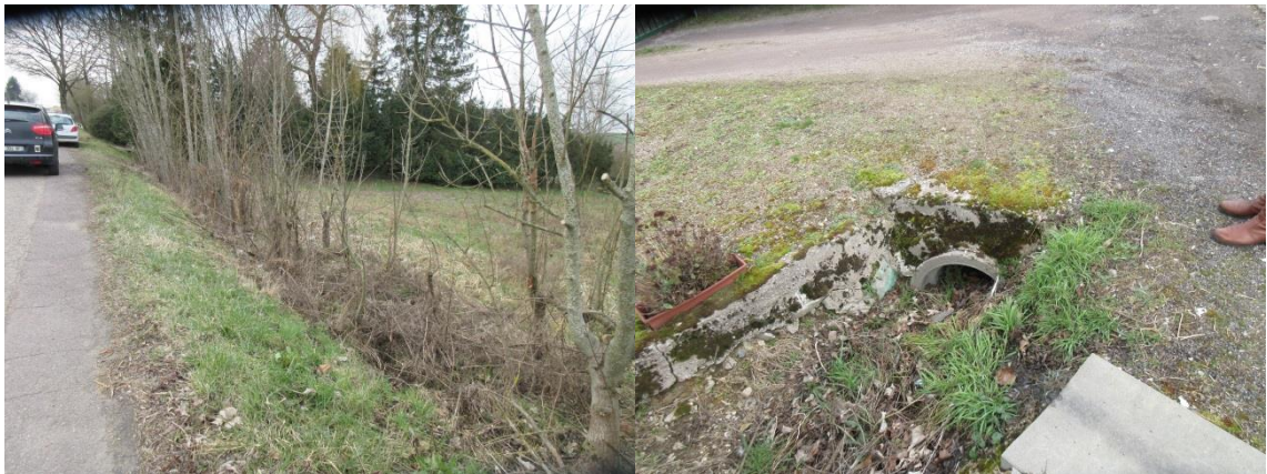
Fig. 7. BV n°2 - Mauvais entretien du fossé
