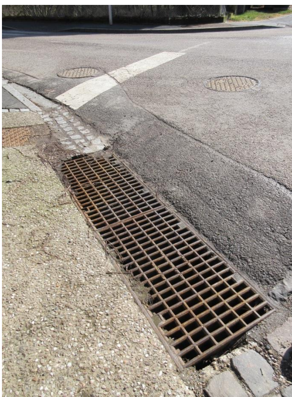
Fig. 7. BV n°1 – Nouvel avaloir (caniveau grille) installé par la mairie
