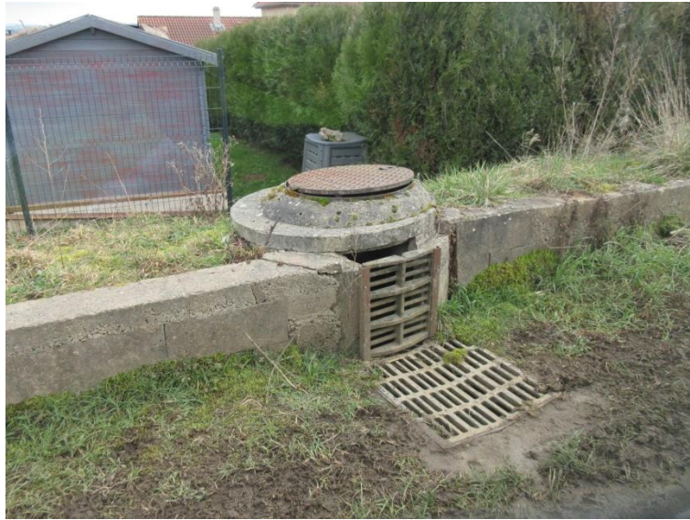
Fig. 4. BV n°1 – regard de canalisation
