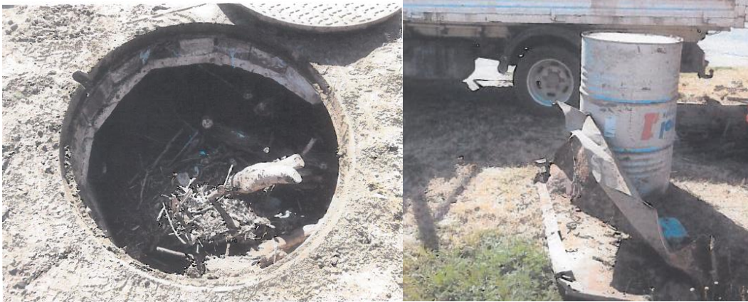
Fig. 8. BV n°1 – Photographies des débris sortis des canalisations (source : mairie)
