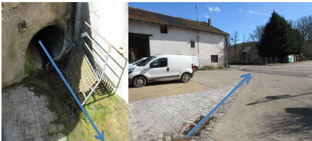
Fig. 6. BV n°1 – Ecoulement sur la route à l'exutoire du bassin versant
