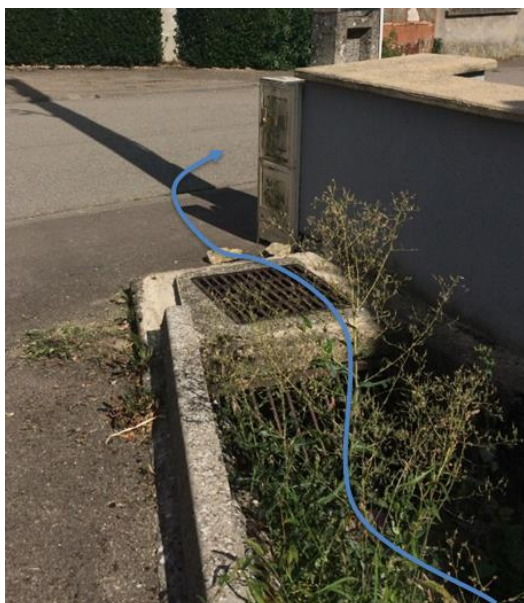
Fig. 3. BV n°1 - Photo de l'avaloir du fossé rue des Tailleurs de Pierres
