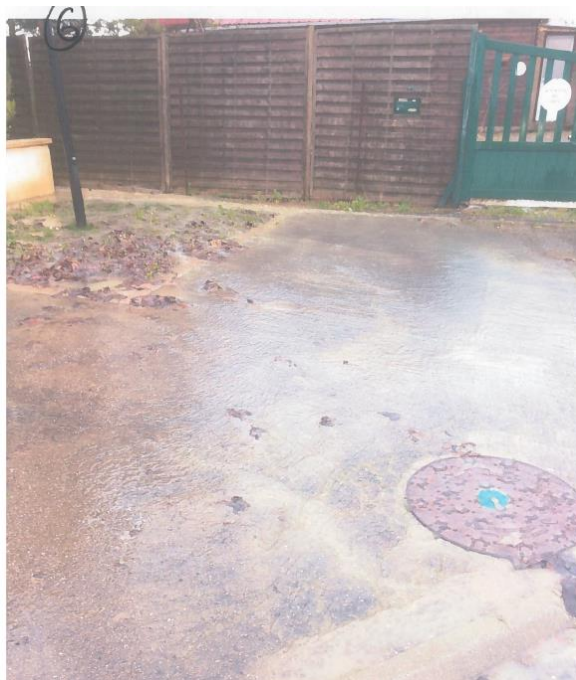
Fig. 2. BV n°2 – Ruissellement sur la rue du Maraîcher (source : mairie)
