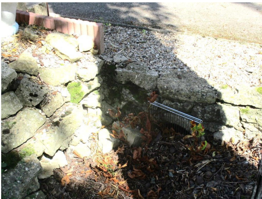
Fig. 3. Grilles pare-embâcles improvisée limitant considérablement la capacité d'évacuation de la buse
