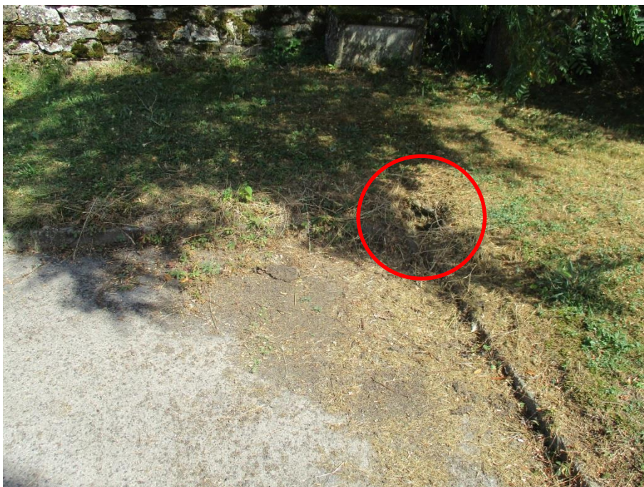
Fig. 5. Buse d'évacuation du cimetière recouverte de déchets végétaux
