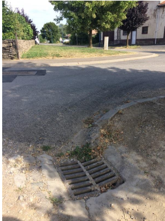
Fig. 4. BV n°1 - Photo de l'avaloir de la place du Lavoir
