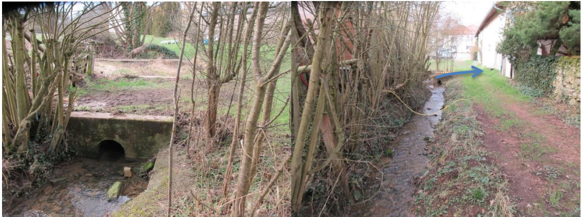
Fig. 6. BV n°2 - Buse qui est entrée en charge et maison inondée au centre du village
