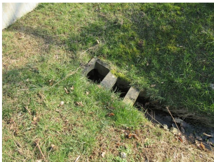
Fig. 5. BV n°1- Entrée de la buse ayant subi un embâcle le 09/02/2016
